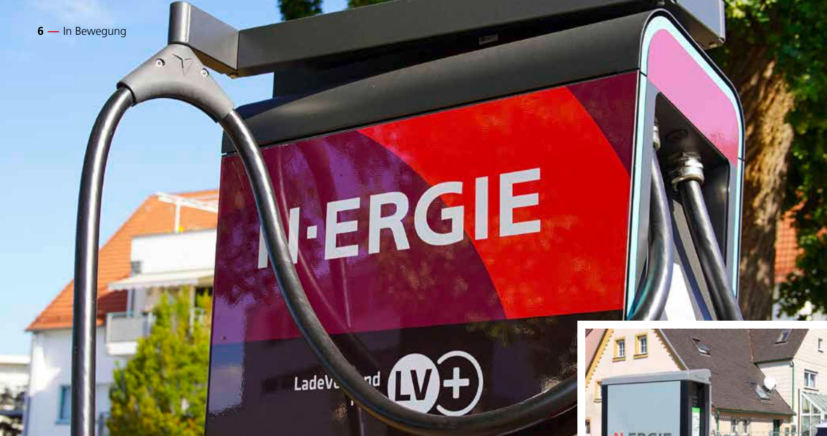
Die Ladesäulen in Schwanstetten (oben) und in Colmburg.
