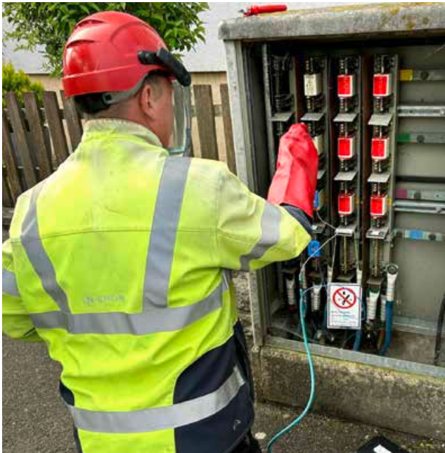
Ein Monteur der N-ERGIE Netz GmbH installiert Komponenten der Breitband-Powerline-Technik an einem Kabelverteilerschrank.
